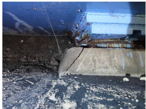
A1 SH4 반침몰탈 파손
