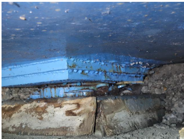
A2 SH5 거푸집미제거 및 반침장치 부식
