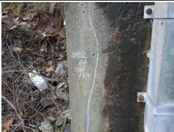
교대 A1 균열(cw:0.3mm)
