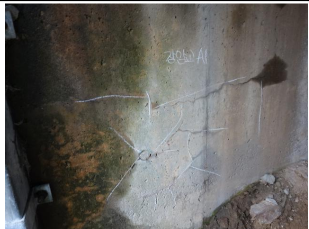
교대 A1 망상균열
