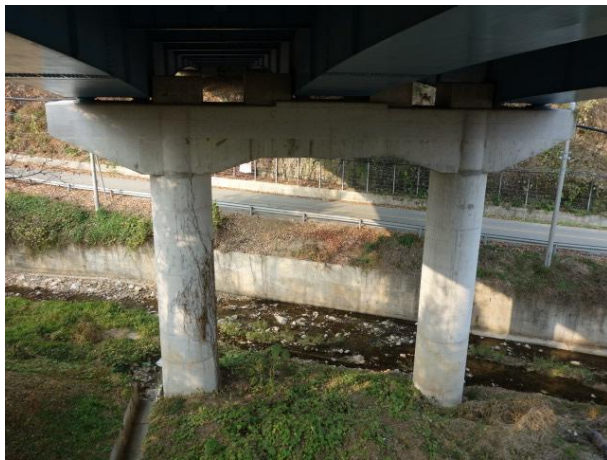
P1 교각 점검로 미설치 전경
