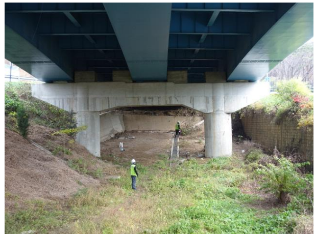
P5 교각 점검로 미설치 전경
